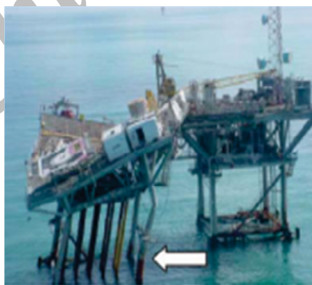
شکل ۱ خرابی سکو ناشی از نیروهای دینامیکی دریا
