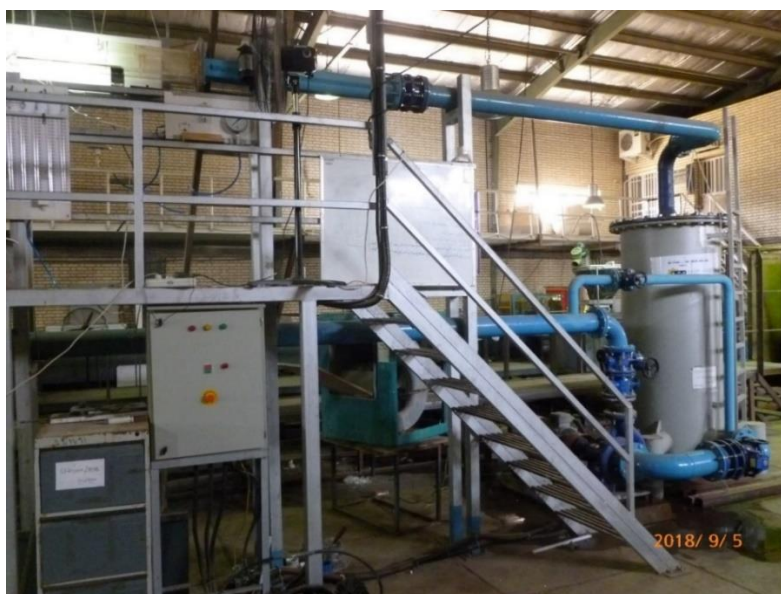
شکل (۱) تصویر تجهیزات تونل آب مدار بسته
