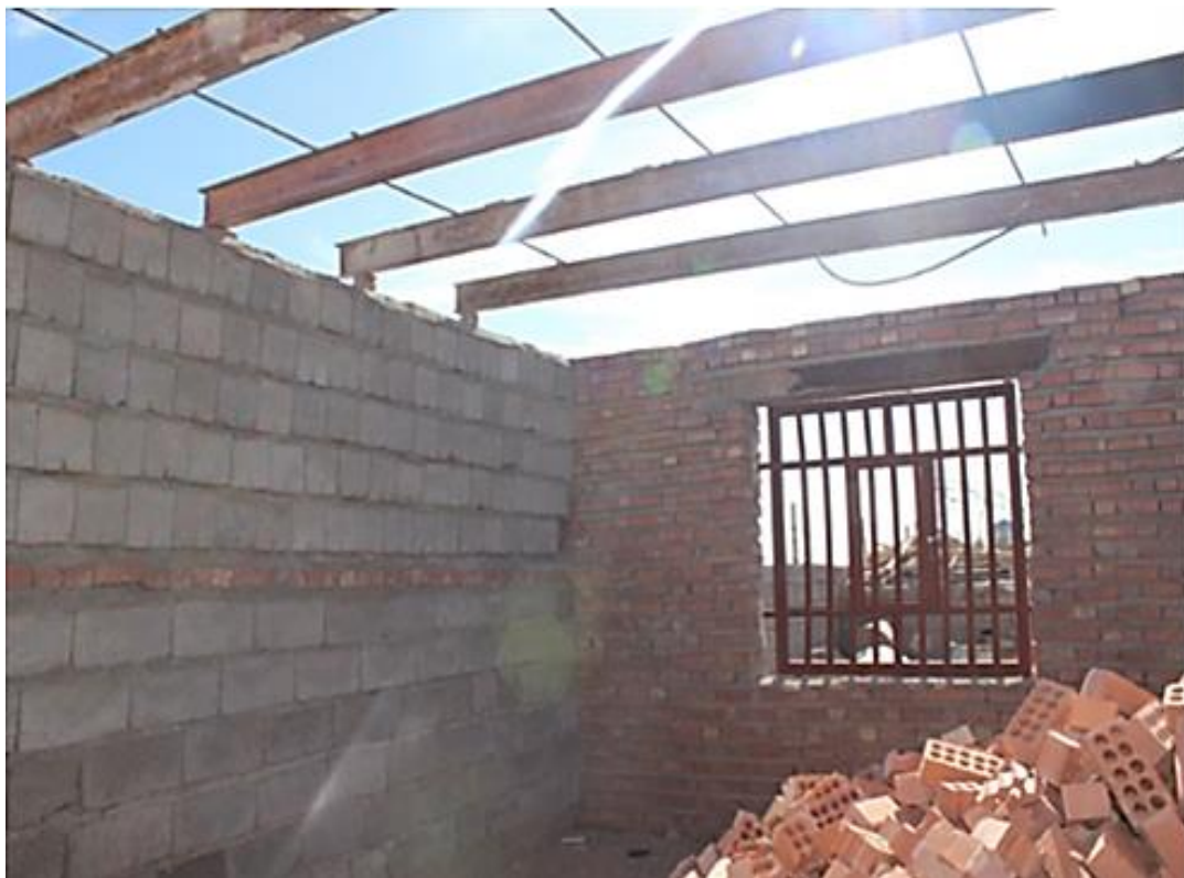
شکل ۴. ساخت و ساز غیر اصولی و غیر مقاوم جهت افزایش زیربنای مسکن بعد از اجرای طرح بازسازی، روستای ابارق بم
