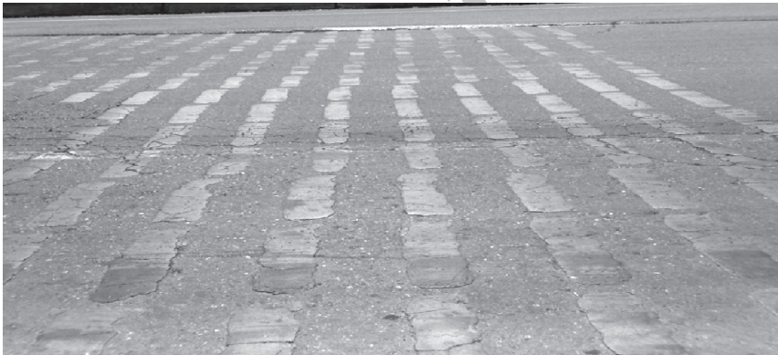
شکل ۱: استفاده از خطوط عرضی اکستروژن برای کاهش سرعت
