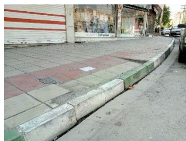
تصویر ۱- تعبیه شدن رامپ از پیاده‌رو به خیابان که بجای خیابان به جدول ختم شده و موجب ایجاد یک پله شده است.
