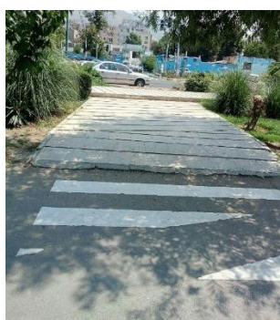
تصویر ۱۰- کفسازی و اختلاف ارتفاع نامناسب
