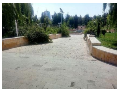
تصویر ۲۱ - کفسازی نامناسب
