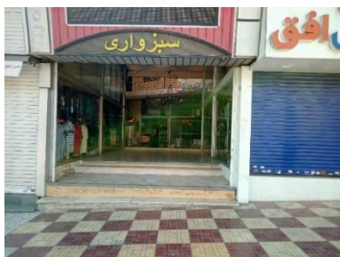
تصویر ۸- کفسازی نامناسب پیاده‌رو که با وجود شیب پیاده‌رو بسیار سر بوده و در صورت خیس شدن موجب سر خوردن می‌شود.
