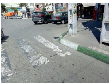
تصویر ۶ - قطع ارتباط پیاده‌رو و خیابان توسط جدول
