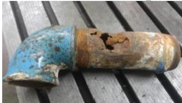
شکل ۱- قطعه تخریب شده و محل خوردگی
