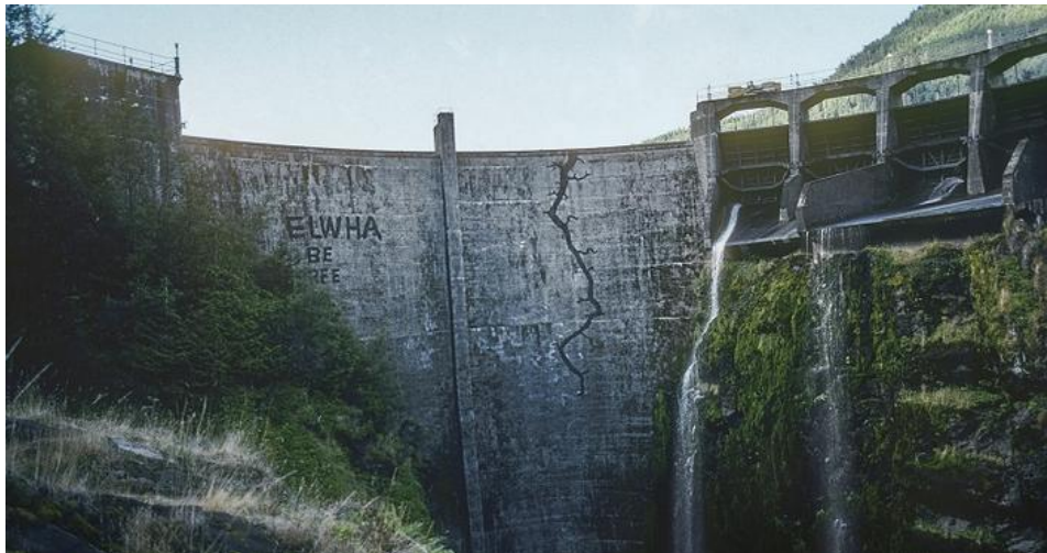
شکل ۱- آسیب دیدگی سازه‌های هیدرولیکی (منبع: https://www.wikipaper.ir )
