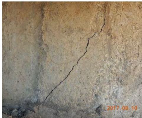
شکل ۲۲: ترک برشی پایه پل مدل آزمایشگاهی.
