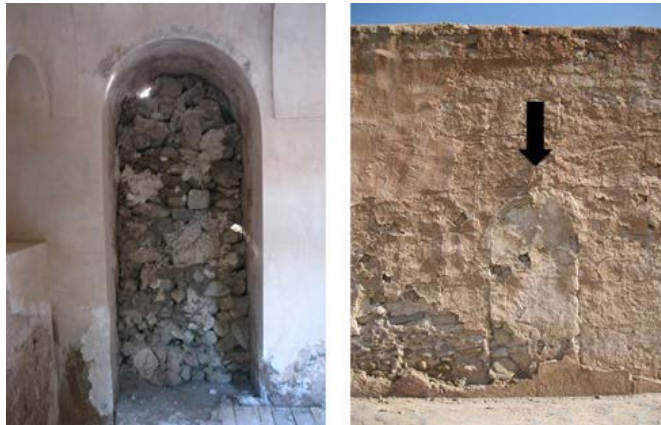
تصاویر ۷. ورودی مسدودشده در ضلع غربی بنای میرغلام هاشمی از نمای بیرون و درونی آن (نگارنده).
