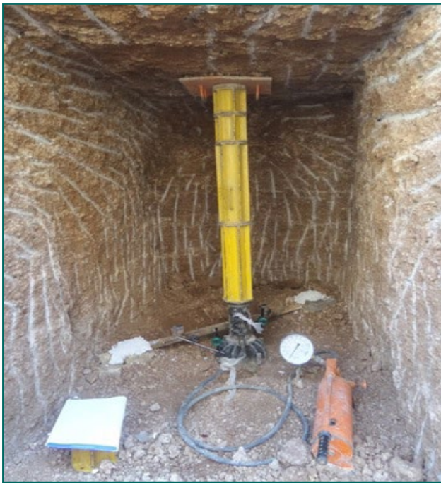
شکل (۴): آزمایش بارگذاری صفحه‌ای در موقعیت چاهک دستی ایستگاه مترو خط ۲ اصفهان.
