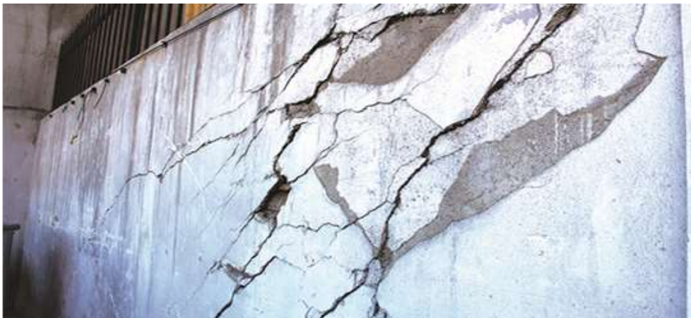
تصویر ۳. نمونه‌ای از دیوار ترک‌خورده‌ی ساکنان محله بافت فرسوده بریانک بر اثر احداث مترو
