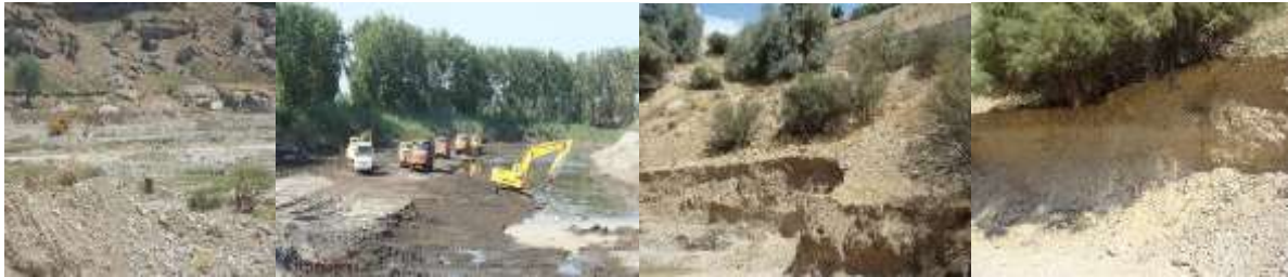
شکل ۴- تخریب بستر و دیواره‌ی رودخانه‌ی بشار
