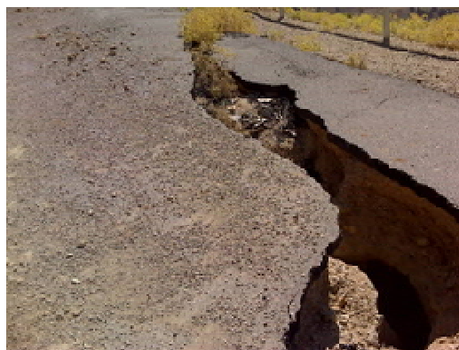
ت 5. شکستگی عمیق (به عمق 3 متر و عرض 0.5 تا 0.7 متر) در اثر حرکت دامنه در پایین دست جاده.
