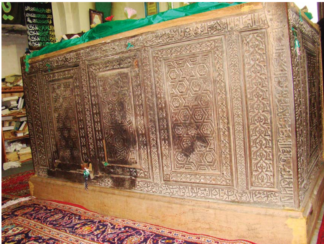
تصویر ۱۵- نمایی از ضلع شمالی که در اثر آتش سوزی آسیب دیده است. تزئینات ضلع جنوبی بر اساس این ضلع صورت پذیرفته است.
