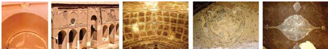
تصویر ۷. نمونه‌هایی از تزیینات گچی با سیم گل، کاهگل و خشت در منازل روستایی اصفهان، این تصاویر به ترتیب (از چپ به راست) از خانه‌هایی واقع در روستاهای تیران (تیران و کرون)، کفران (رودشت)، جعفرآباد (تیران و کرون)، قورتان (رودشت) و سه شاهین‌شهر و میمه) اخذ شده‌اند، مأخذ: همان.
