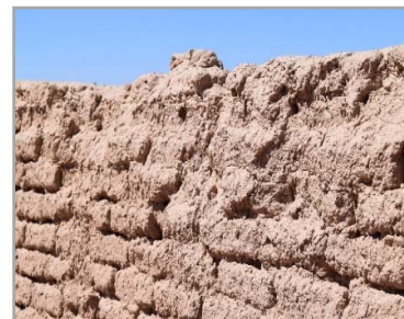
آسیب در رأس دیوار بازسازی شده
