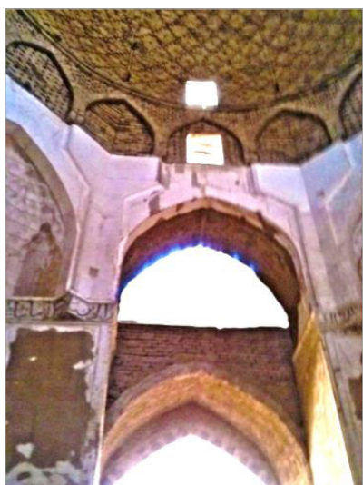
تصویر ۲۷. پشت بغل تخریب‌شده گنبدخانه در قسمت سردر (نگارندگان)
