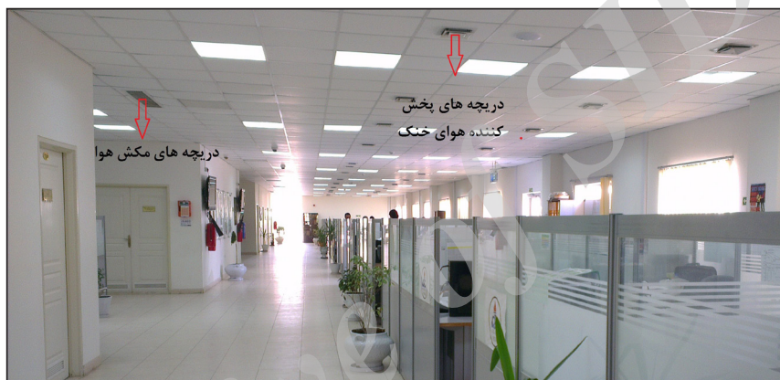
شکل ۴. دریچه‌های پخش و مکش جریان هوا در ساختمان اداری
