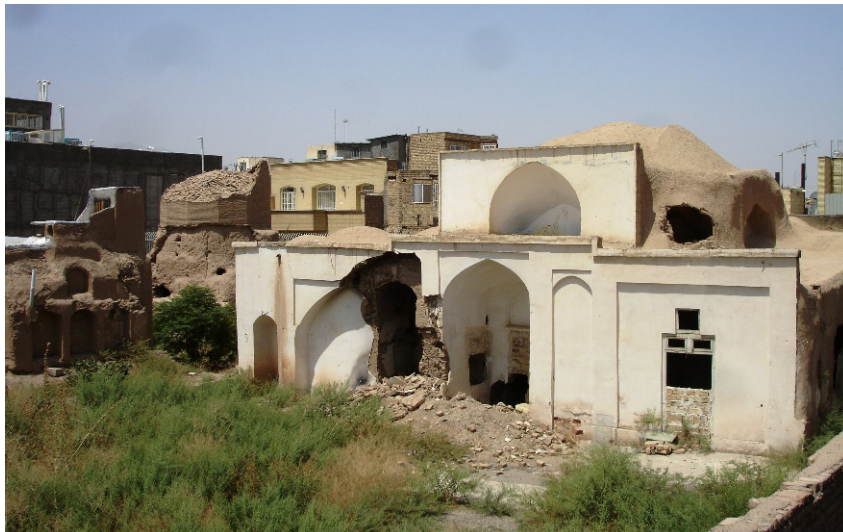
تصویر ۱۰: بنای دارای طاق بزرگ در میانه که در جلو آن صحن بزرگی قرار داشته است. این بنا در سال ۱۳۹۷ تخریب شده است.
