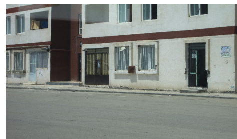
تصویر شماره ۵: ضعف در ساخت و اجرای ساختمان‌ها در مجتمع وحدت
