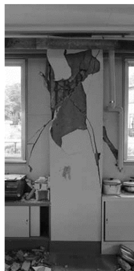
شکل ۱۱) شکست ستون و دیوارهای مجاور به دلیل بتن‌ریزی همزمان؛ زلزله ۲۰۱۱ تو هوکو ژاپن [33]
