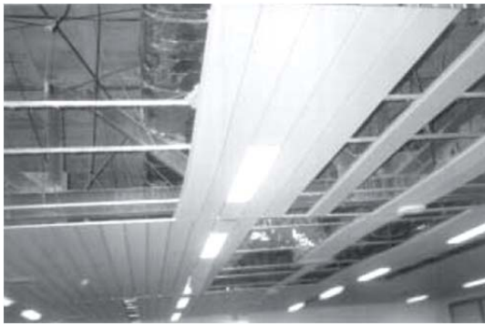
شکل ۹) فروریختن پنل‌های سقف کاذب؛ زلزله ۱۳۸۲ بم [24]
