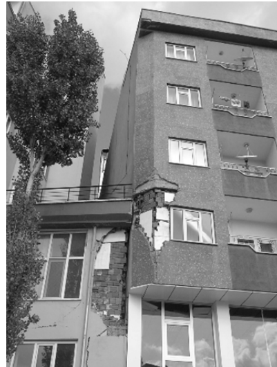
شکل ۴) آسیب ناشی از ضربه ساختمان مجاور، زلزله ۲۰۱۱ وان ترکیه [18]
