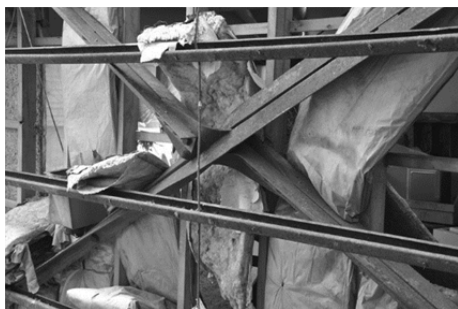
شکل ۱۲) کمانش پیچشی جانبی در محل تقاطع مهاربندی: زلزله ۲۰۱۱ تو هوکو ژاپن [33]
