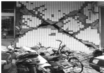
شکل ۳) تشکیل ترک های قطری ایجاد شده در دیوار مصالح بنایی غیر مسلح [23]
