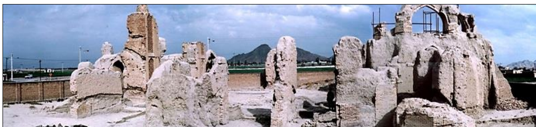
تصویر ۲۷- نمای جبهه غربی مسجد جامع هفتشویه (بهشاد حسینی و ایمان پیمانی، ۱۳۸۳).
