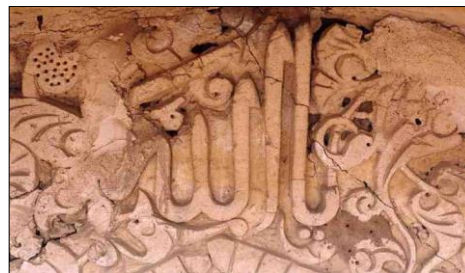
تصویر ۴۹- جزئیات گچبری ضلع غربی گنبد خانه با سوراخ‌های ناشی از کلونی موریانه (نگارندگان، ۱۳۸۵)
