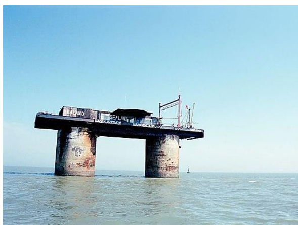
شکل (۱): خرابی یک سازه بتنی تحت تأثیر عوامل فیزیکی و شیمیایی
