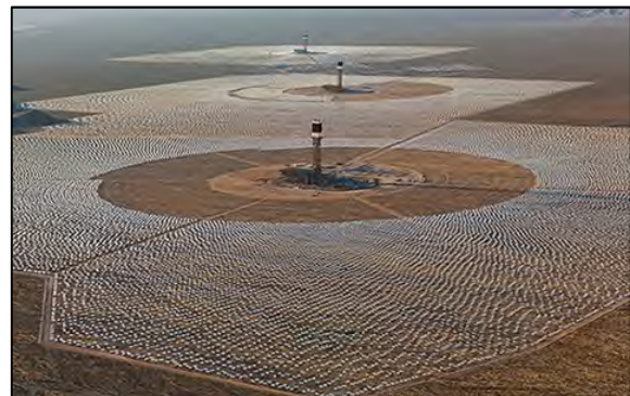
شکل 35: نیروگاه برج خورشیدی اویانپاسولار متشکل از سه واحد به ظرفیت مجموع 400 مگاوات در کالیفرنیا آمریکا [49]
