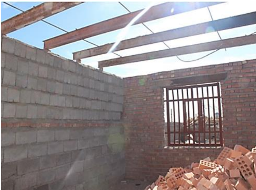
شکل ۴. ساخت و ساز غیر اصولی و غیر مقاوم جهت افزایش زیربنای مسکن بعد از اجرای طرح بازسازی، روستای ابارق بم
