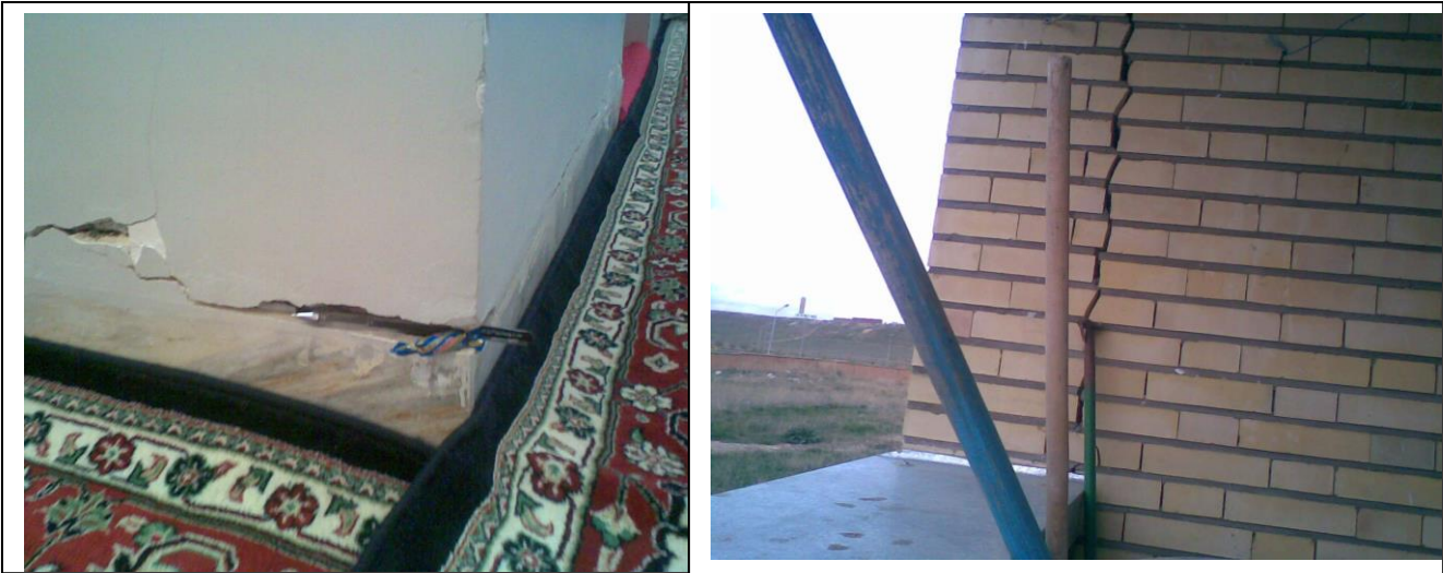
شکل ۷ و ۸: نمائی از محل بر خورد پایه ساختمان با کف اتاق در پذیرائی که در اثر فرونشست با ترک چند سانتی متری (منبع نگارنده)
