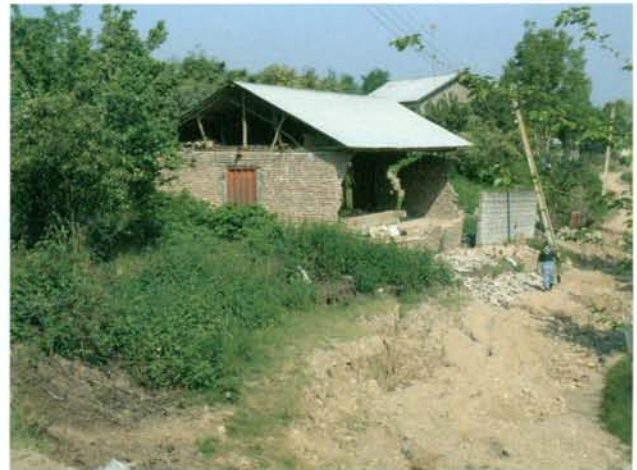
تصویر ۲- عملکرد حرکت رانشی زمین در تخریب محل‌های مسکونی و باغات، روستای ولیک جنوب بابل
