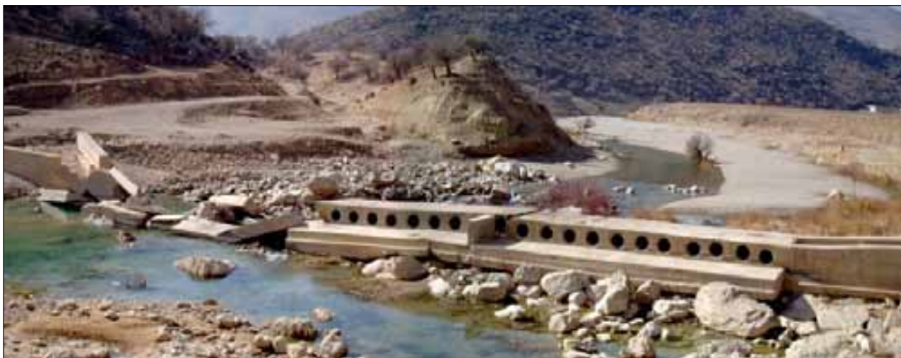
تصویر ۱۲- نمایی از پل تخریب شده توسط سیلاب‌های رودخانه‌ی قره آغاج
