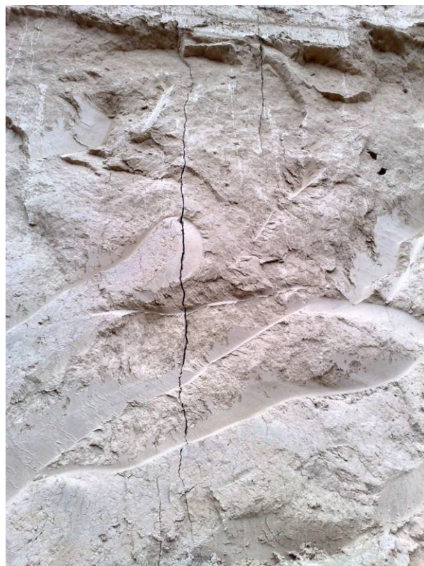
تصویر ۱۷- تداوم ترک‌های کششی نسبت به عمق در لس‌های ناحیه ۱
