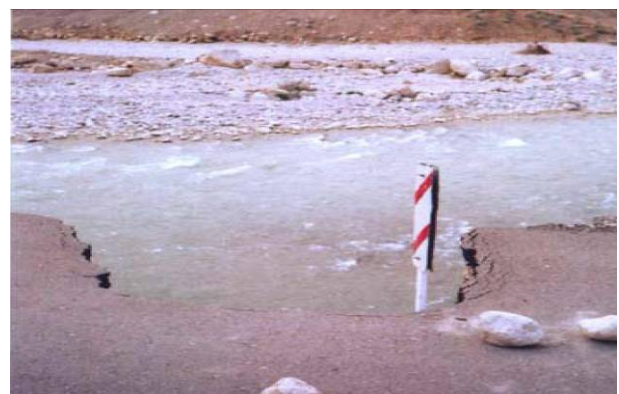
تصویر ۱۲ - تخریب جاده ناشی از زیرشویی توسط رودخانه
