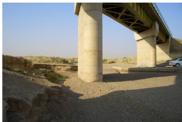
تصویر ۱۰- آب‌شستگی پایه پل‌ها که این خود در اثر برداشت بی‌رویه مصالح از رودخانه می‌باشد - زمستان ۱۳۸۹
