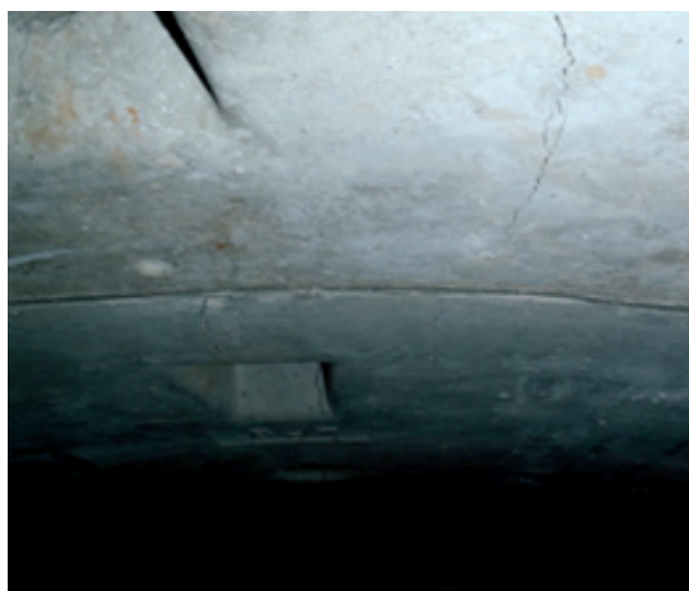
تصویر ۴- ترک‌های ایجاد شده در سگمنت‌های سقف تونل
