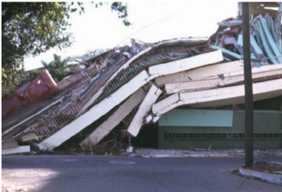
تصویر شماره ۱۴: فروری سقف طبقات بر روی یکدیگر (زلزله بم) (منبع: آرشیو استاد: علی اصغر وطنی اسکویی)
