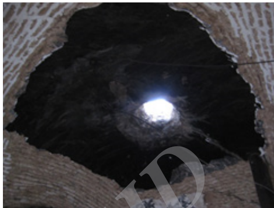
تصویر شماره ۷: هواکش سقفی اجرا شده در حجره مسقف با تاق اسلامی
