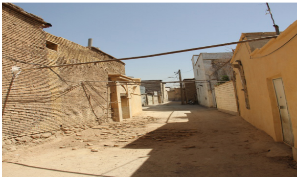
تصویر شماره ۵: ریختن بخشی از سقف ساختمان بر اثر باریدن باران
