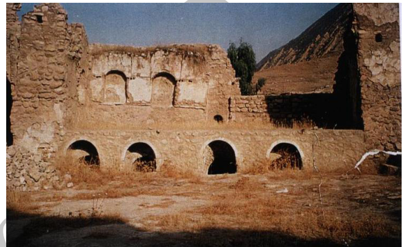
تصویر شماره ۸: نمایی از بازسازی دیوارهای زیرزمین در ضلع شرقی بنا (دید از داخل حیاط)، مأخذ: ارجمندی، ۱۳۸۴، ۱۴۹
