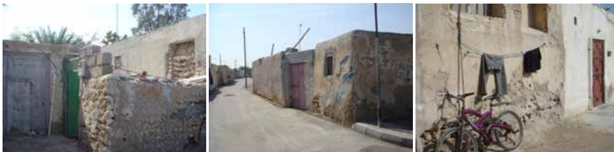
تصویر ۵: فرسودگی کالبدی شدید در محله
