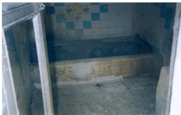
تصویر شماره ۴- نمایی از وضعیت نامساعد حمام های آب گرم رینه لاریجان
