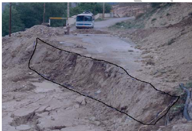
تصویر شماره ۵- تنها راه روستای رینه که بر اثر ریزش تخریب شده است
