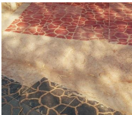
شکل ۳. اتصال نامناسب کفسازی ها
