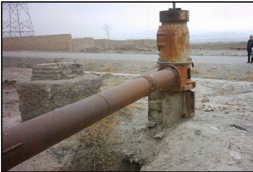
شکل شماره ۵- پدیده لوله زایی بر اثر فرورفتگی زمین در محدوده روستای حسن خوردو ( شمال غربی دشت )
