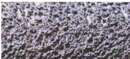
شکل ۱۳- آثار مکانیزم Erosion روی سطح لوله‌ای از جنس فولاد نرم که در مسیر تخلیه توربین قرار گرفته بود [۱۸]
