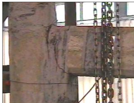
شکل ۵- پاره شدگی دورپیچ و سپس ورقه L شکل اتصال Base-P1
