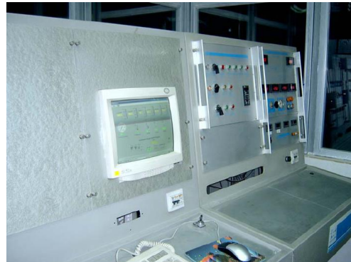
شکل ۴- پنل کنترل تونل باد
