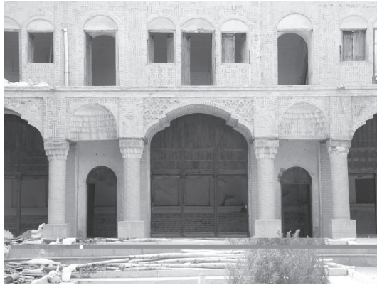
تصویر ۲. نمای طبقات همکف و اول از درون حیاط تیمچه صرافیان؛ ماخذ: نگارندگان.
