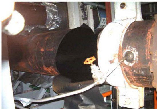
شکل ۸- ترکیدن خط کندانس ۱۲۲ اینچ ناشی از FAC [۲]
