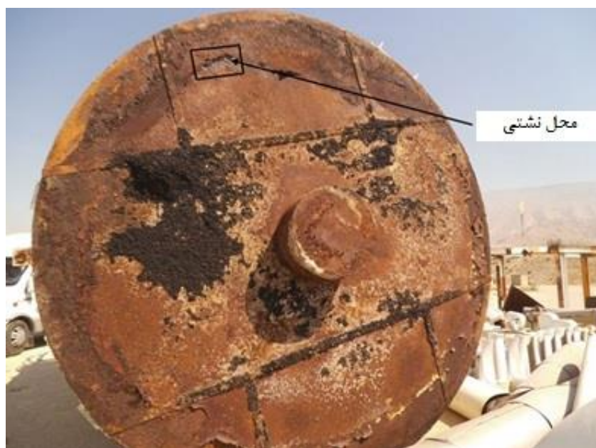
شکل ۹- نشتی مشاهده شده بر روی کف مخزن
