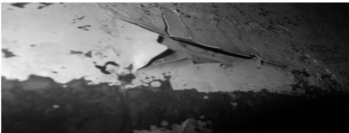
شکل ۹- تخریب پوشش اعمال شده در اثر اعمال نامناسب و لرزش دستگاه
