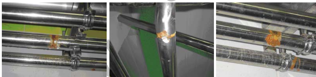
شکل ۲- خوردگی لوله ها پیرامون گرده جوش.
