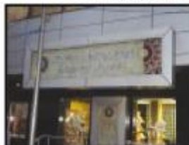
نقطه ضعف: نصب غیر ایمن تابلو برجسته به بدنه ساختمان
